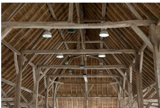
La charpente en bois, dont la majorité des pièces sont d'origine. © Christian Rome, 2015
